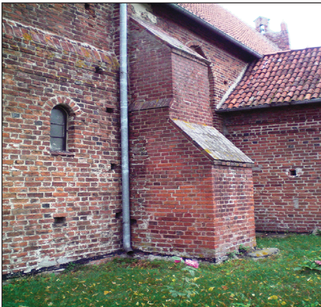
Fot. 5. Południowa ściana kościoła w Mątowach Wielkich, na której zaznaczone są znaki wielkiej wody (9.06.2009)
