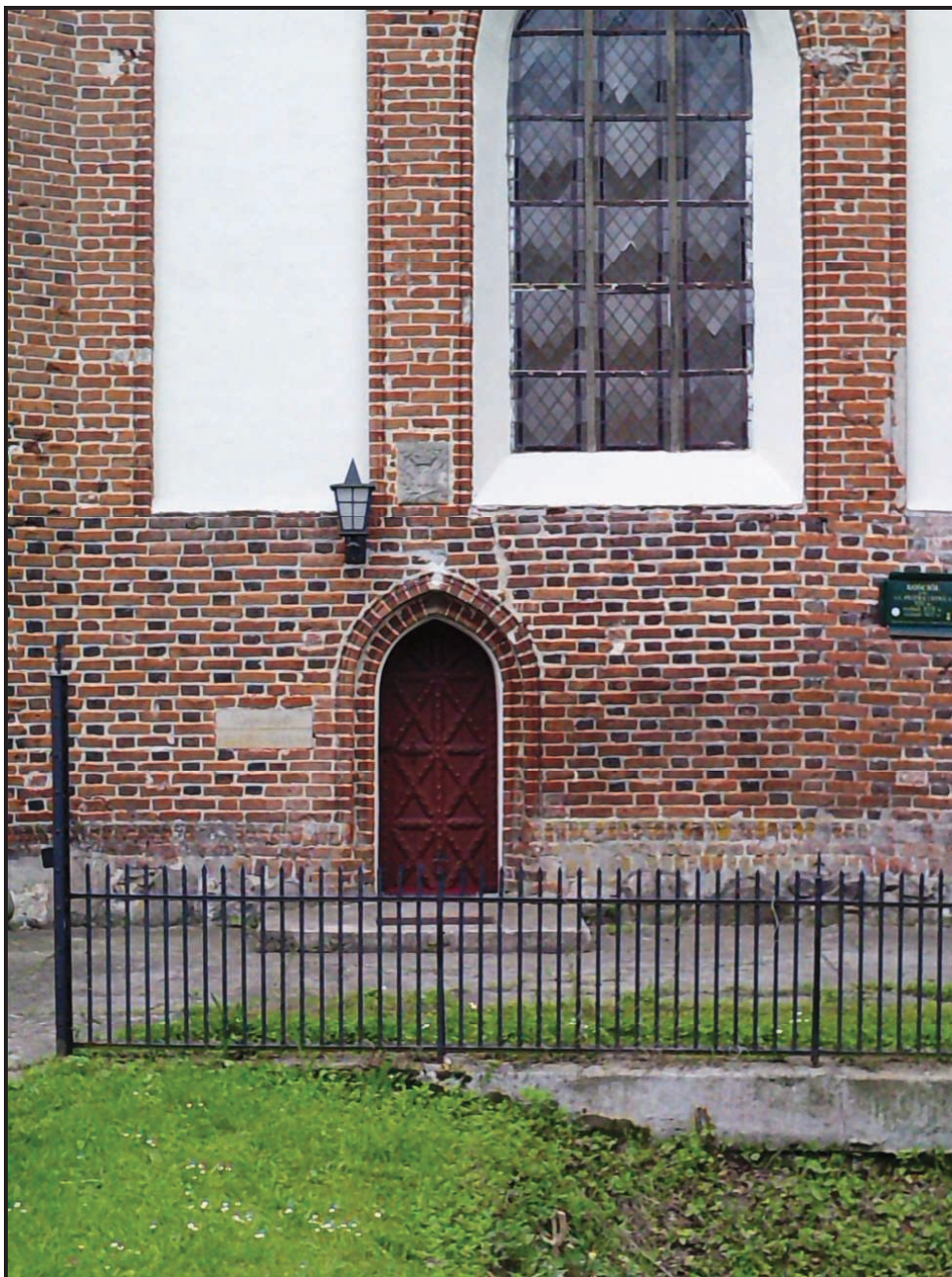
Fot. 21. Znak wielkiej wody Wasserstand von 10 bis 13 April 1829 umieszczony na ścianie kościoła w Trutnowach (4.06.2009)
