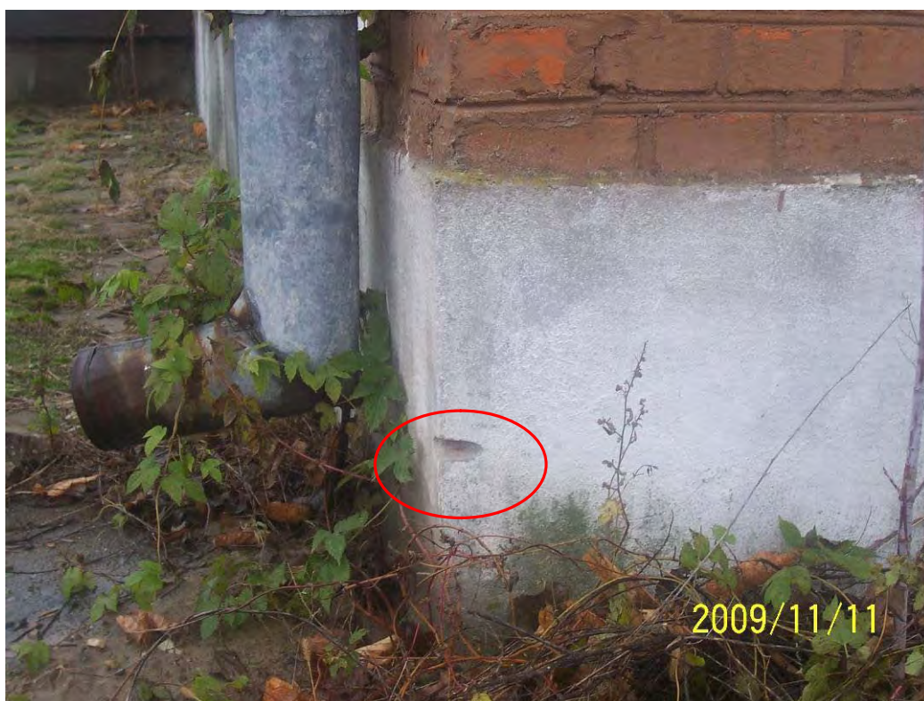
Fot.8 Rysa w ścianie magazynu przy ulicy 6-ego Sierpnia 5 w Puławach, upamiętniająca powódź z lipca 2001 roku (11.11.2009).
